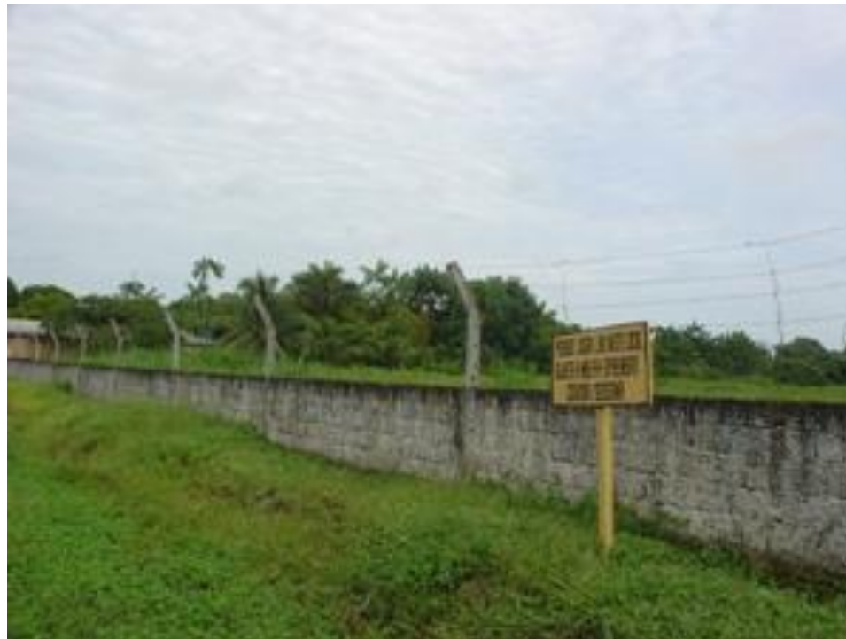
Cerca patrimonial rompida
