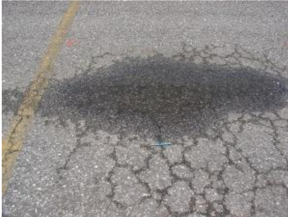
Trincas no pavimento do pátio de estacionamento de aeronaves
