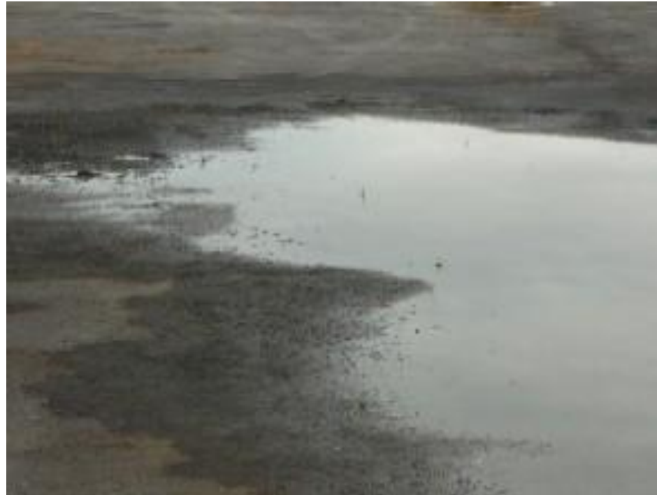
Empoçamento de água na pista de pouso e decolagem
