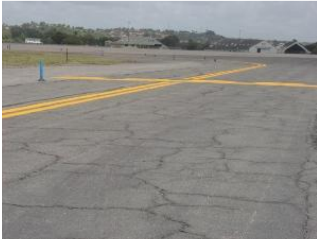
Trincas no pavimento da pista de táxi
