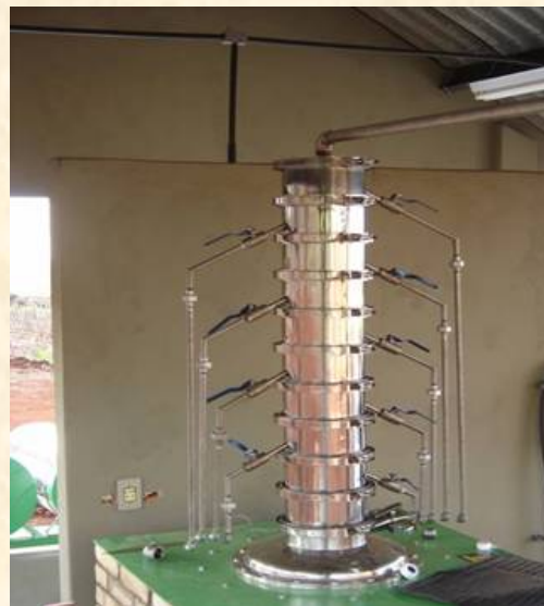
coluna destiladora acima do forno de alvenaria
