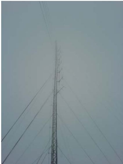
TORRE COM 40m DE ALTURA
