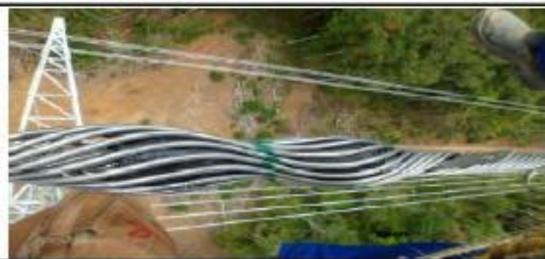
Figura 3.2 – Torre 313-1 Detalhe na grampeação do cabo OPGW apenas do lado direito (tramo 308-1 a 313-2).
