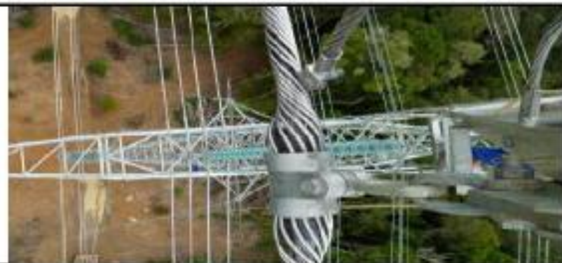
Figura 3.1 – Torre 313-1. Detalhe na Grampeação do cabo OPGW apenas do lado direito (tramo 308-1 a 313-2)
